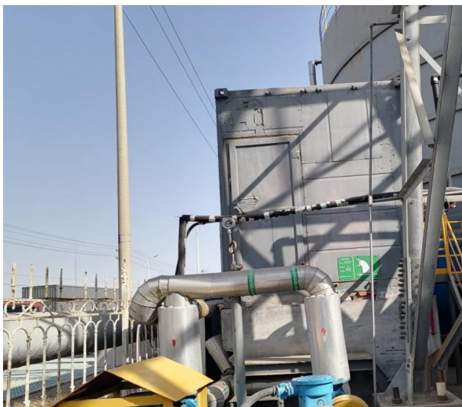
废水总排放口
